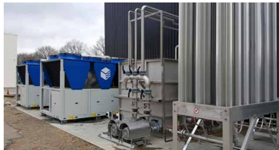
De koelmachines staan in een gesloten systeem in verbinding met een platenwarmtewisselaar.
