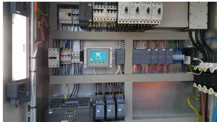
Een kijkje in de PLC kast. Ebbens ontwikkelde zelf de aansturingsoftware voor de installatie.
